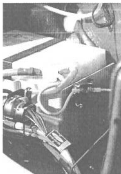
FUSIBLE LIGNE BATTERIE
